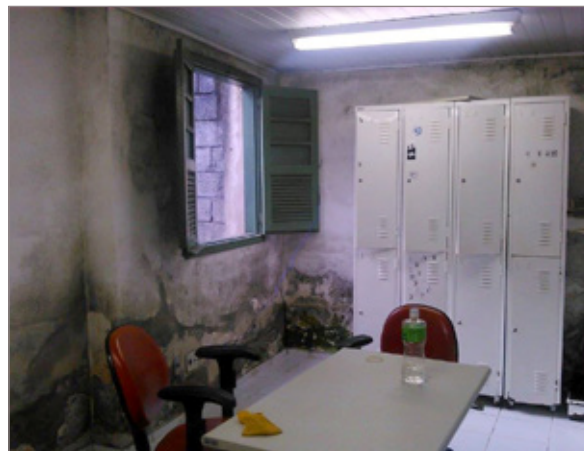
Estabelecimento estava em condições precárias
