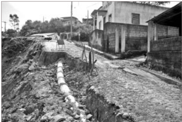
Voçoroca invadiu a rua e ameaça casas
